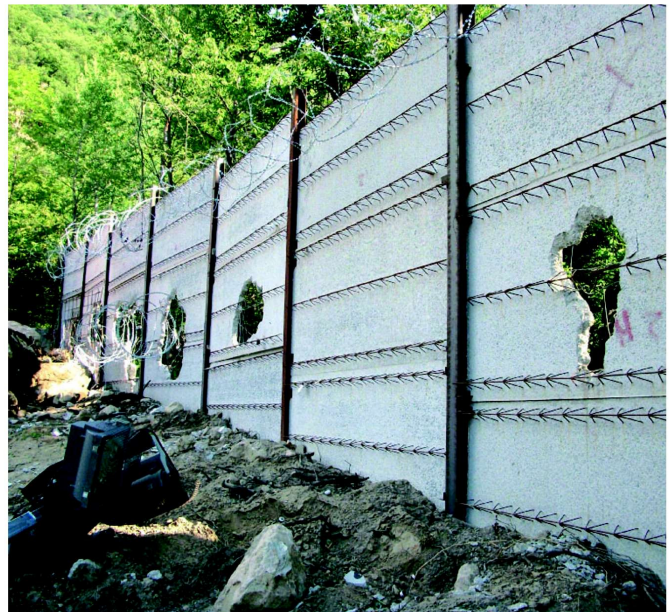
DANNI Abbattuto in alcuni punti il muro di recinzione del cantiere che è già stato riparato
