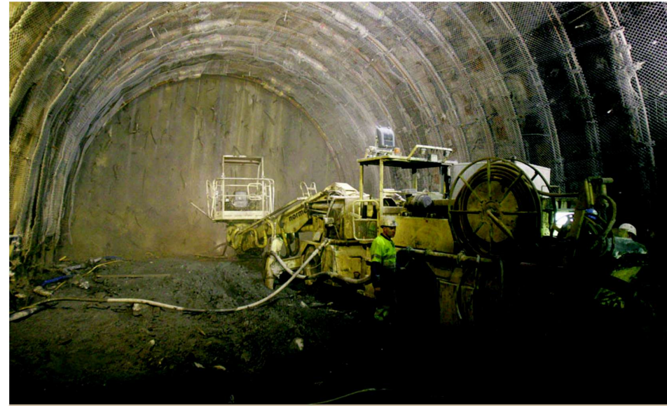
CANTIERI A giugno comincia la recinzione dei terreni alla Maddalena per lo scavo del tunnel geonostico
