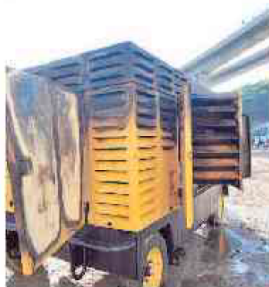
Il compressore danneggiato
