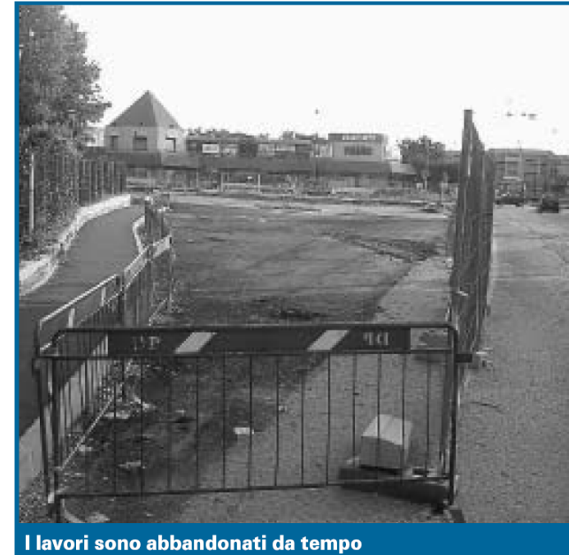
I lavori sono abbandonati da tempo
