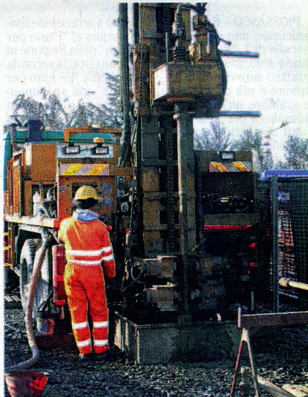
ORBASSANO - Trivelle al lavoro a gennaio, durante i sondaggi allo scalo di Orbassano per la futura linea ferroviaria Torino-Lione.
