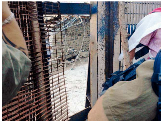
Le reti tagliate al cantiere della Tav il giorno dell'aggressione alla giornalista
